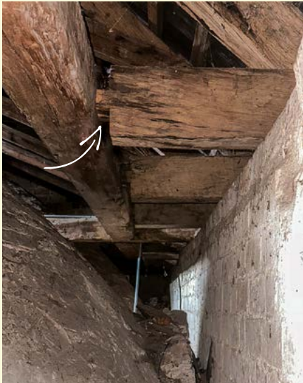
Die Verzapfung der Holzbauteile sitzt nicht mehr richtig.
